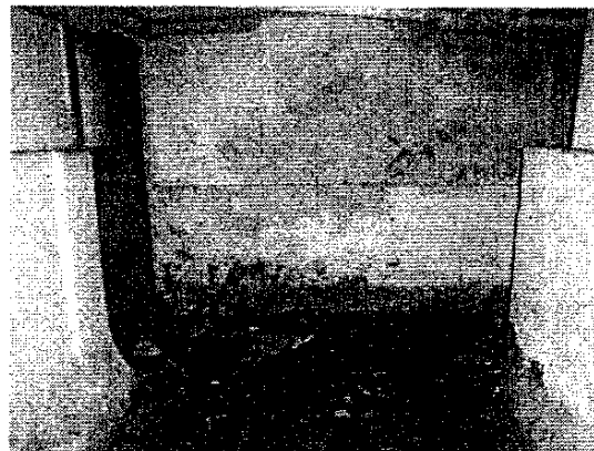
Feuchtigkeitsschäden, Ausgang zum Hof
